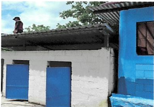
Foto 1: Remodelación de baños, cambio de estructura metálica y lámina, pintura de baños.
